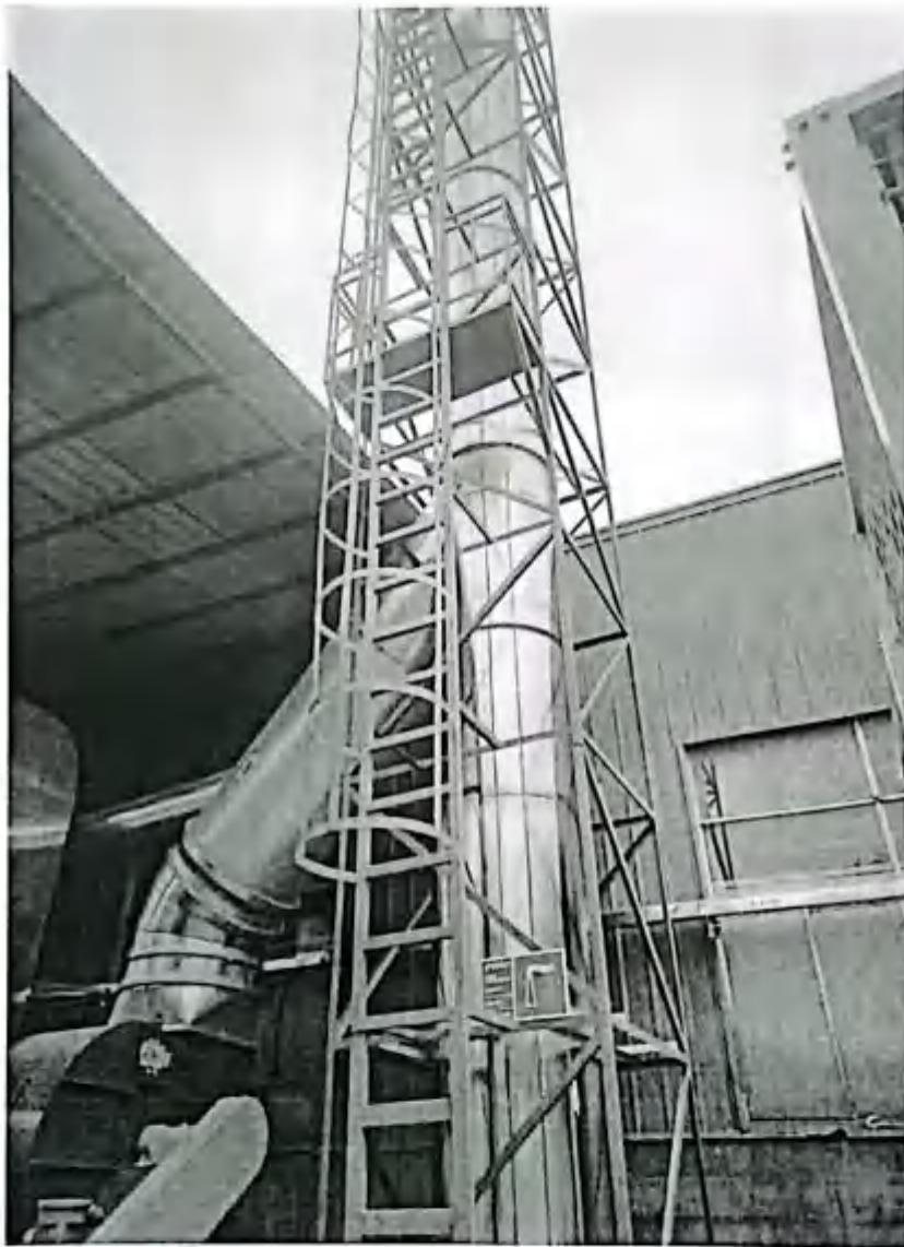
附图1 废气处理设施总排口
