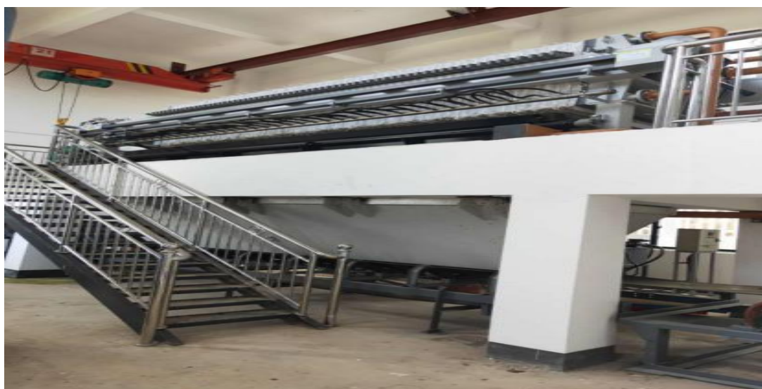
图3 新墙镇污水处理厂污泥脱水间
